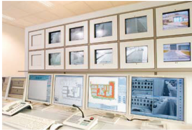
Bild 2: Sicherheitszentrale mit sämtlichen Sicherheitskomponenten wie PNA, Videoüberwachung, Schlüsselsicherung, Zellenkommunikation, Brandmeldeanlage usw.
