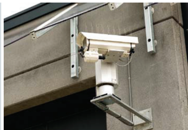
Bild 4: Auf dem Außengelände und in sämtlichen Gebäuden sind insgesamt mehr als 90 Kameras installiert, ausgestattet je nach Einsatzgebiet mit Schwenk-/Neigekopf, Zoomfunktion, Heizung, Taubenabwehrkamm und Scheibenwischer zur Spinnenabwehr
