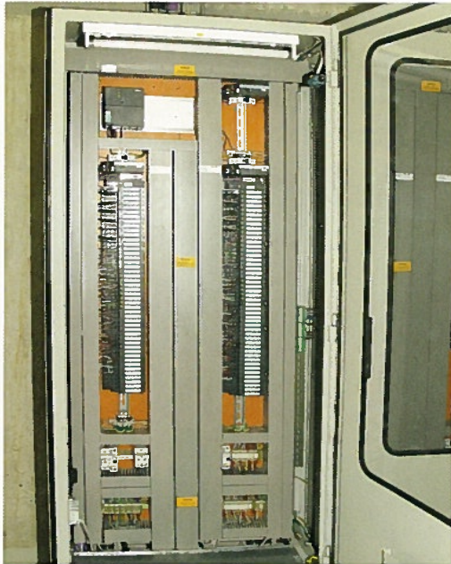
Detailansicht MSR-Schalterschrank mit S7-300 und ET200-Peripherie
