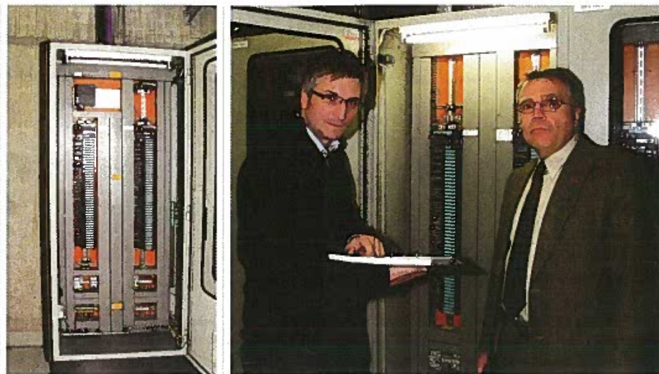
Detailansicht MSR-Schaltschrank mit S7-300 und ET200-Peripherie
