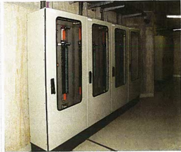
MSR-Schaltschränke mit neuer ET200-Peripherie in einer der Lüftungszentralen
